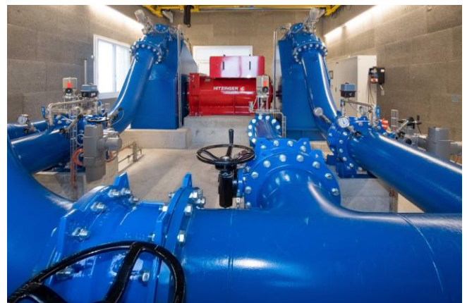
Wasserzuleitungen auf die beiden Turbinen (blau), rot in der Mitte befindet sich der Generator
